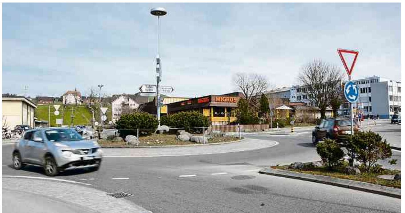
Tiefe Spurrinnen und Risse im Belag: Der Migros-Kreisel in Appenzell ist schon älteren Datums und bedarf der Sanierung.
